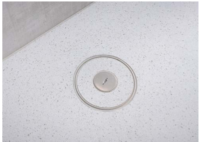
Bei diesem Bodentank im Heidelberg Congress Center wurde sogar der Deckel mit Terrazzo belegt.
